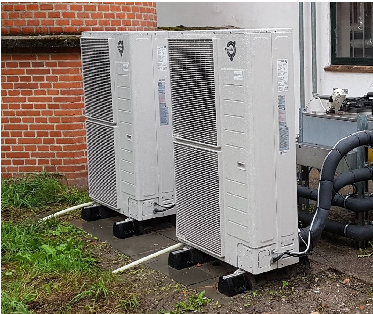
Figur 18 Varmepumper ved Livø El- og varmeværk.
