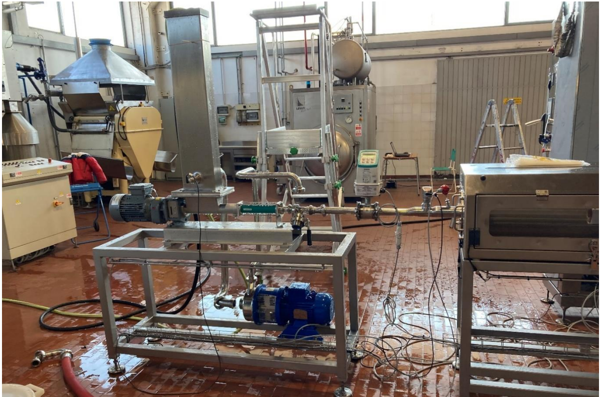
Figur 3. Fylde – snækkepumpe – flowmåler – temperatur- og ledningsevne måler.
