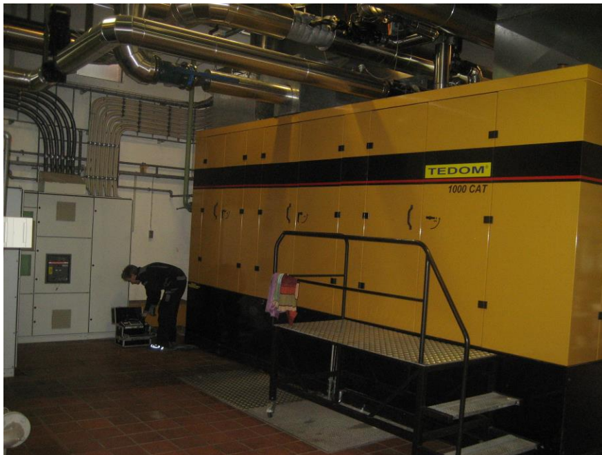
Figure 5 One of the two Tedom/Caterpillar units at Nørager Varmeværk
