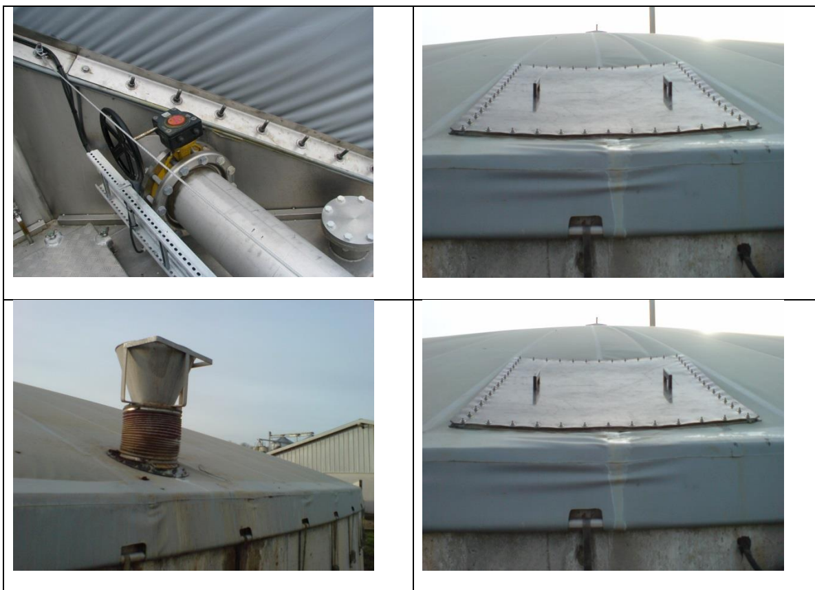
Figur 2. Eksempler på lækager ved samlinger på nyetablerede duge på efterafgasningstanke. Alle lækager blev detekteret i 2. målerunde, og der er således ikke registreret hvilke løsninger, der er anvendt til udbedring af lækagerne.
