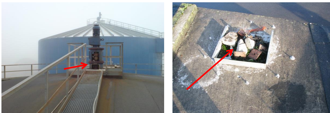
Figur 11. Til venstre: Pakdåse ved omrører. Til højre: hul i efterafgasningstak. Biogasanlægget var bekendt med hullet, og det var planlagt, at der snarest skulle monteres en metalplade til afdækning.
