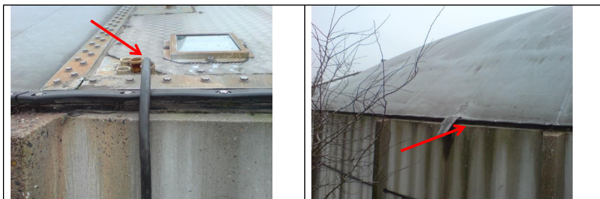
Figur 1. Eksempler på lækager ved samlinger. Til venstre ses lækage ved slangegennemføring. Til højre ses lækage ved samling mellem betonvæg og membran på efterafgasningstank
