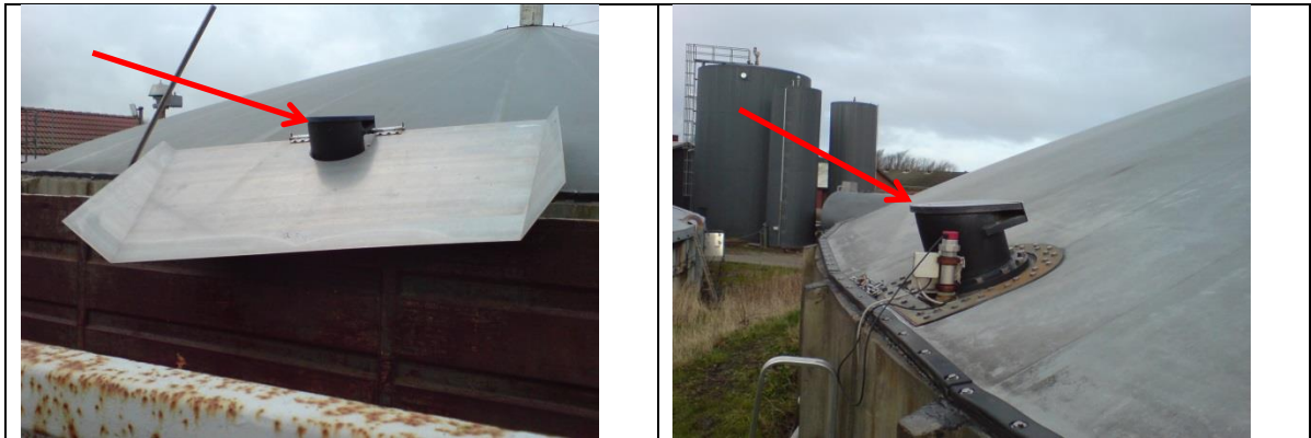
Figur 7. Eksempler på lækager i forbindelse med klapventiler.
