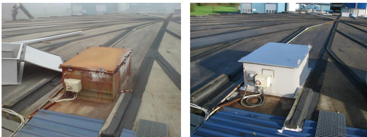
Figur 8. Metalkasser på toppen af efterafgasningstanke, som sikrer adgang til omrører. Til venstre en ældre kasse, som på billedet til højre er udskiftet med en ny.
