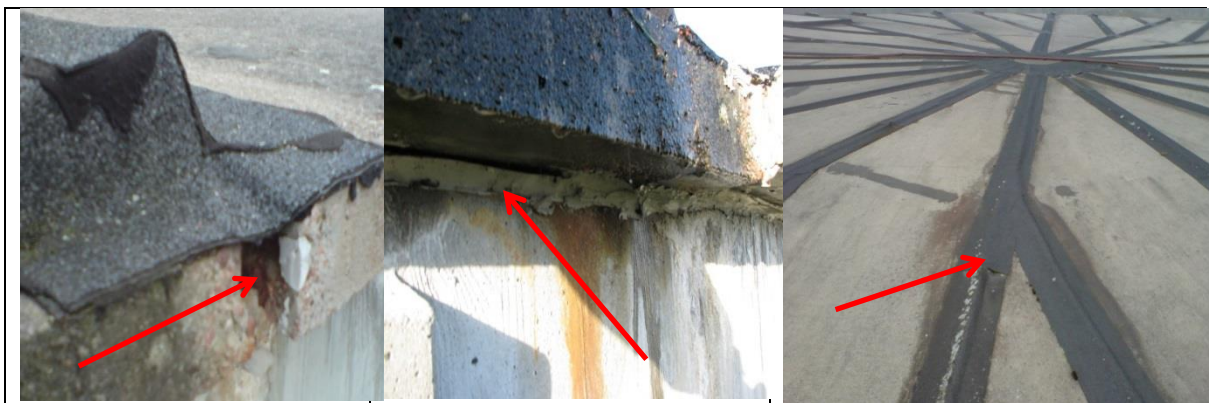
Figur 3. Eksempler på lækager mellem betonfag på efterafgasningstanke. De to billeder til venstre viser samme lækage mellem væg og overdækning, henholdsvis før og efter reparation med fugemasse. Nederste billede til venstre viser lækager mellem betonfag i overdækning på efterafgasningstanke.
