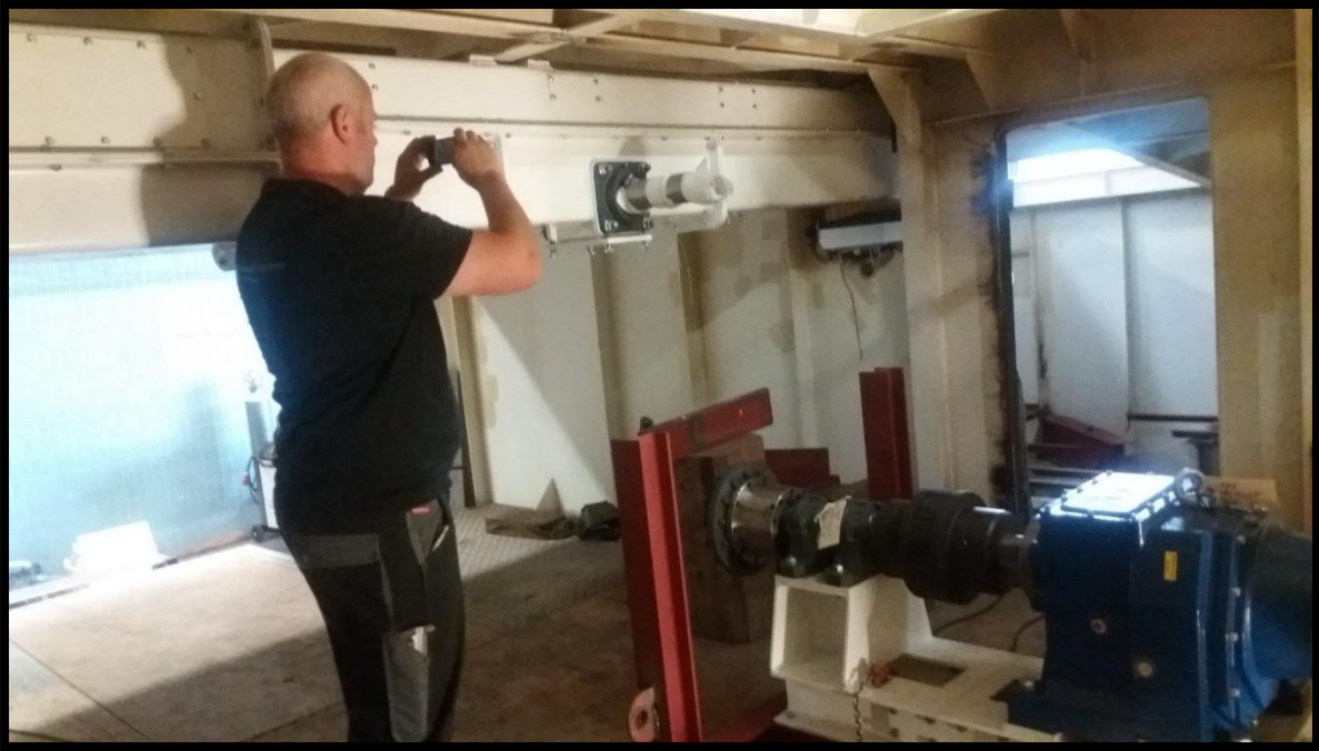
Lineærgear og PTO i anlægget
