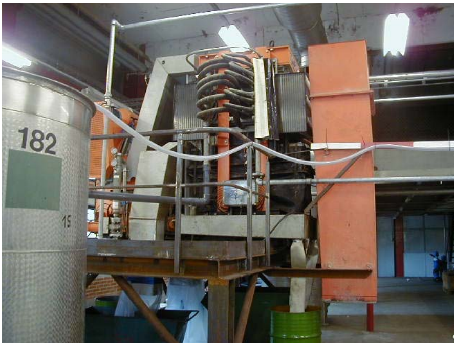
Foto nr. 2. Trykfilter.
