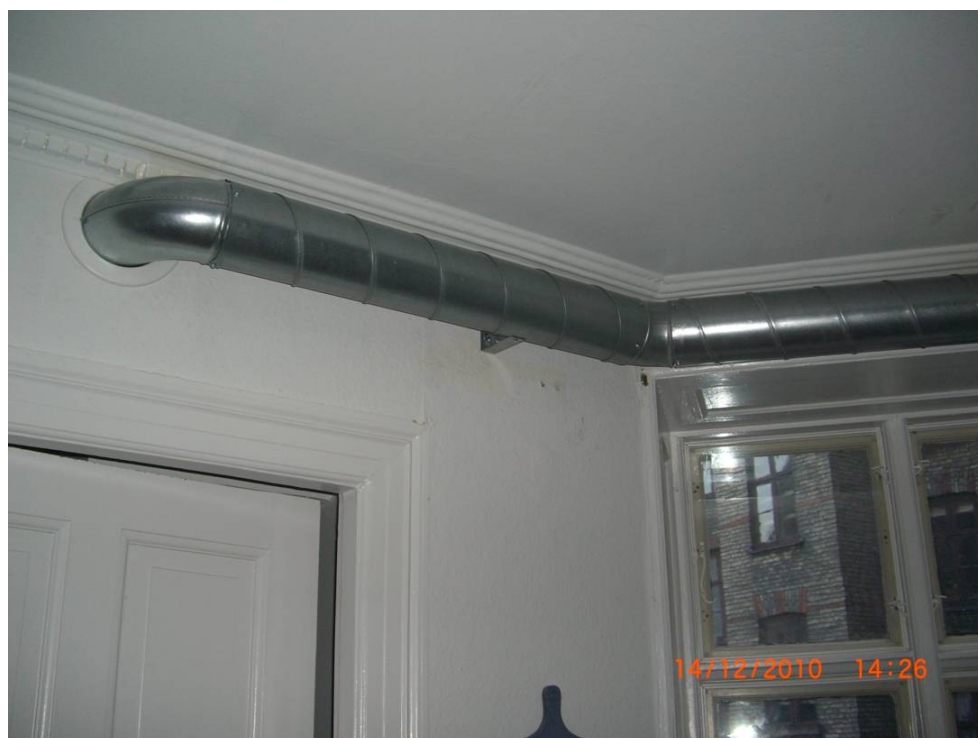
Figur 57: Rørføring til emhætte i køkken via stue.
