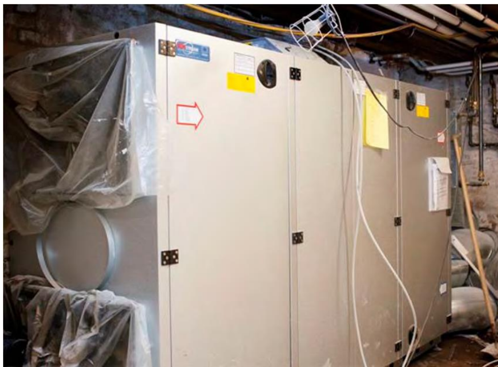
Figur 5: Traditionelt centralt placeret mekanisk ventilationsanlæg i kælderen.
