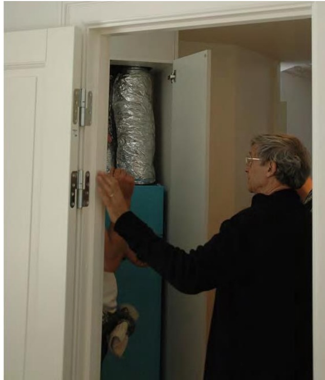
Figur 6: Decentralt ventilationsanlæg i et køkkenskab
