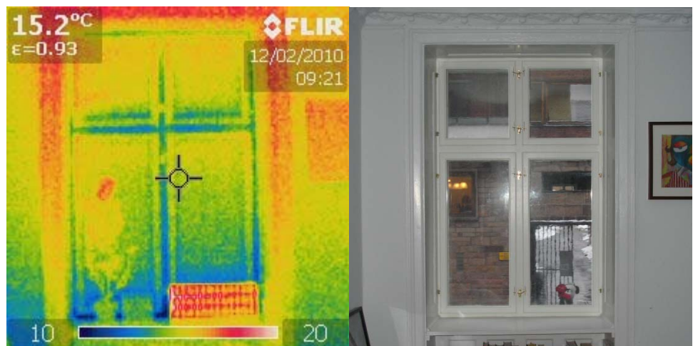
Figur 47: Vindue 1 i stuen mod gaden (1+2 løsning med forsatsramme). Overfladetemperaturen på ruderne er ca. 15 grader.
