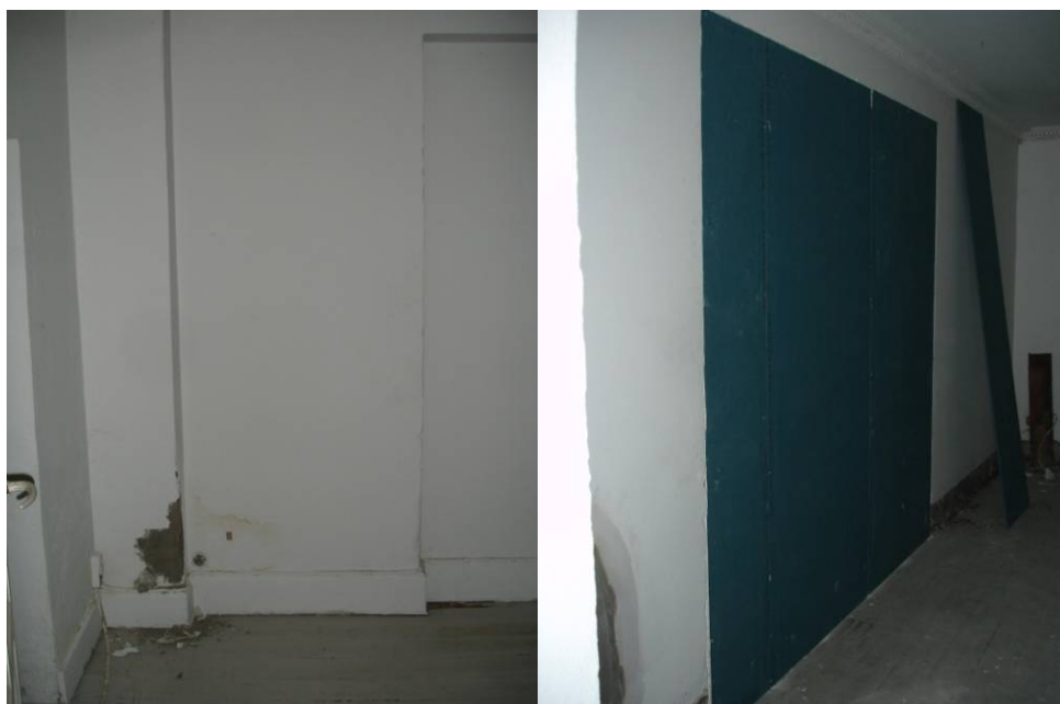
Figur 7: Billeder fra væggen i stuelejemålet inden montering af indvendig efterisolering. En sparniche i muren blev udfyldt med alm. isolering og lukket med vådrumsgips inden montering.
