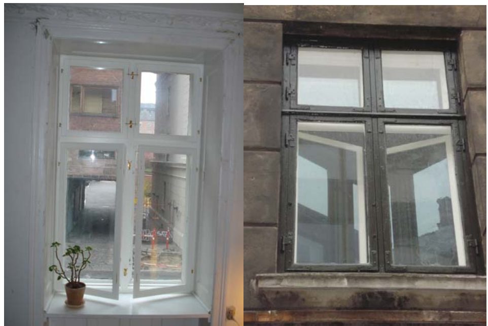
Figur 38. Energirenoveret 2-fags dannebrogsvindue med 1+1 forsatsløsning - set inde- fra og udefra.
