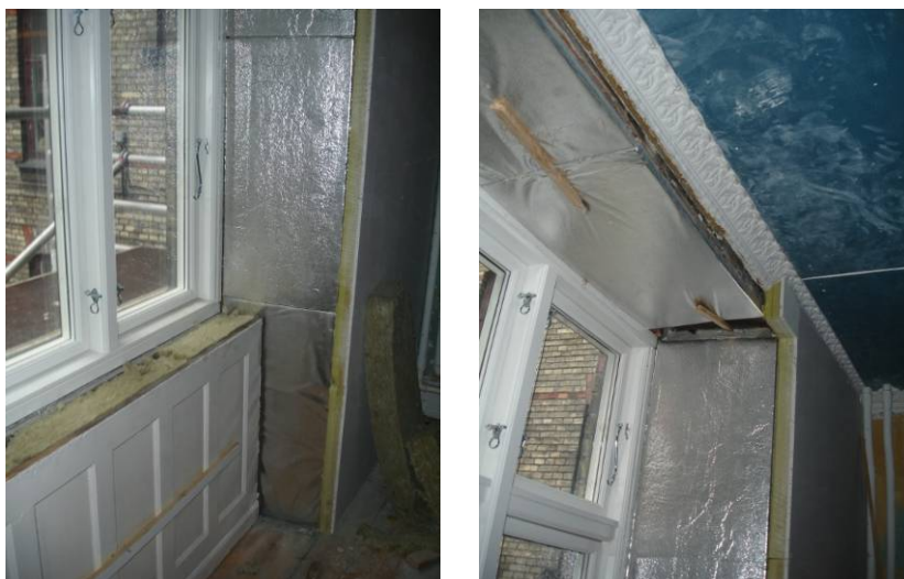
Figur 15: Nogle af vakuumpanelerne så ud til at miste deres vakuum under montering. Her nederst til venstre og øverst til højre. Det viser sig ved at de skarpe folder på folien bliver bløde, det kan ikke ses på fotoet.
