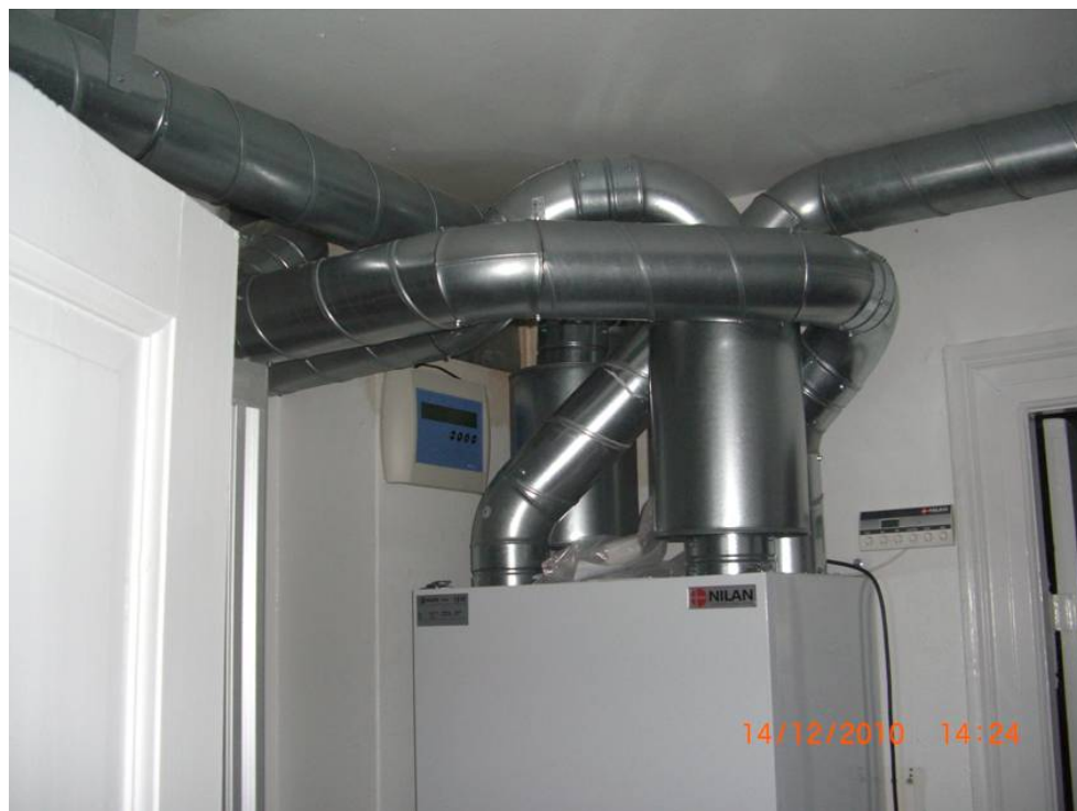
Figur 56: Ventilationsanlæggets placering i badeværelset samt rørføring under loft.
