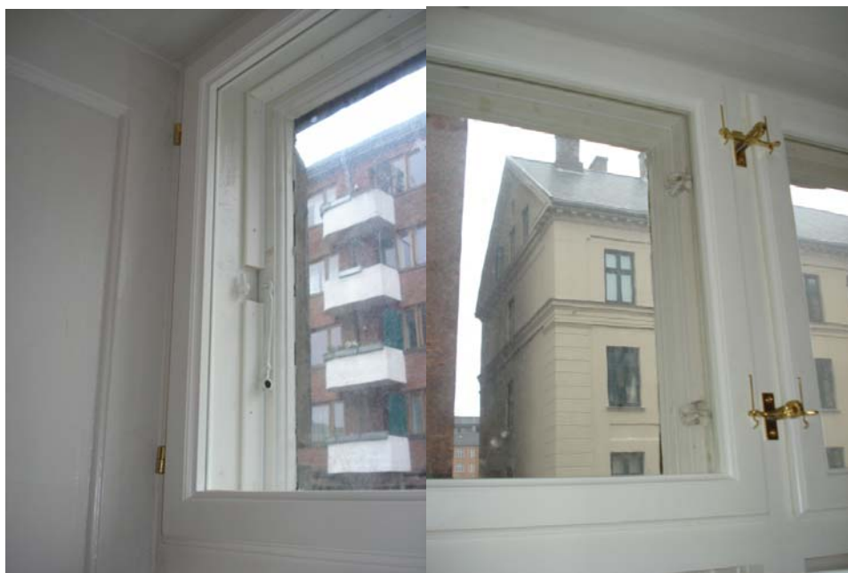
Figur 39. Nærbillede af anslagsliste for ny tætningsliste, hvor der af hensyn til mulighed for ventilering af fugt er udeladt tætningsliste ved stormkroge og hasper.
