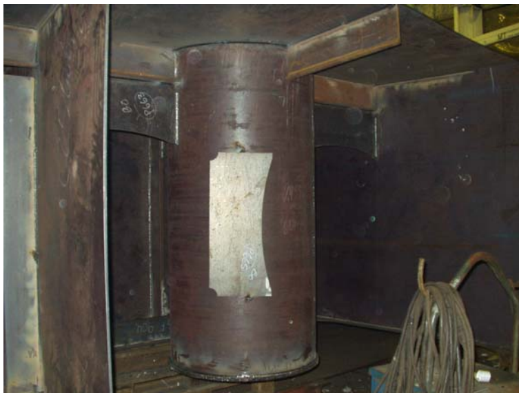
Brønd til montering af Flygt pumpe.
