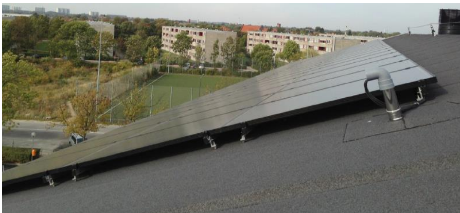
Fig. 2. 5 Traditionel installering af solceller på tagpap tag. Solcellerne er monokrystallinske. De er orienteret mod vest-sydvest og vinklen er 30°
