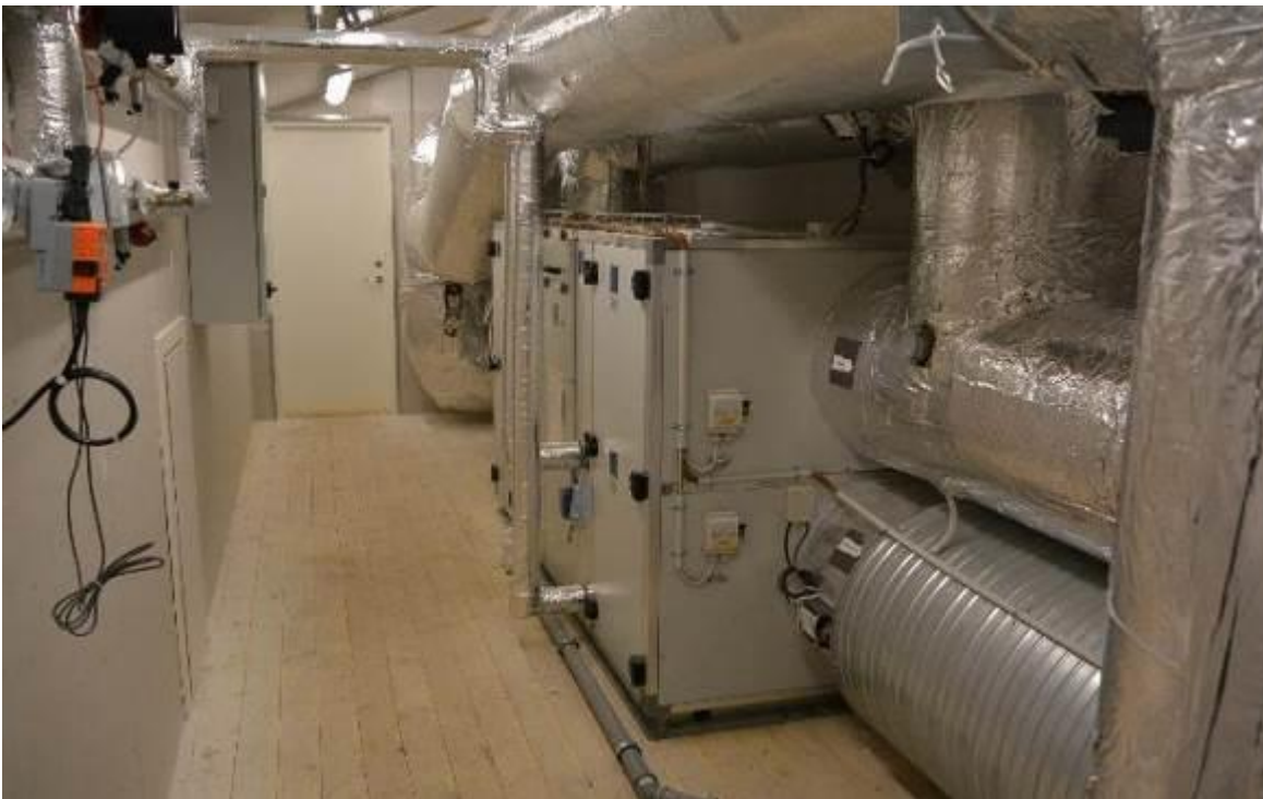
Fig. 2. 14 Det centrale varmegenvindingsystem i Hornemanns Vænge.
