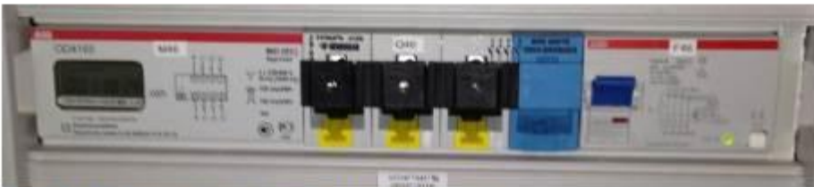
Figur 8 - Tilslutning af solcelleanlæg i tavle i kælderen
