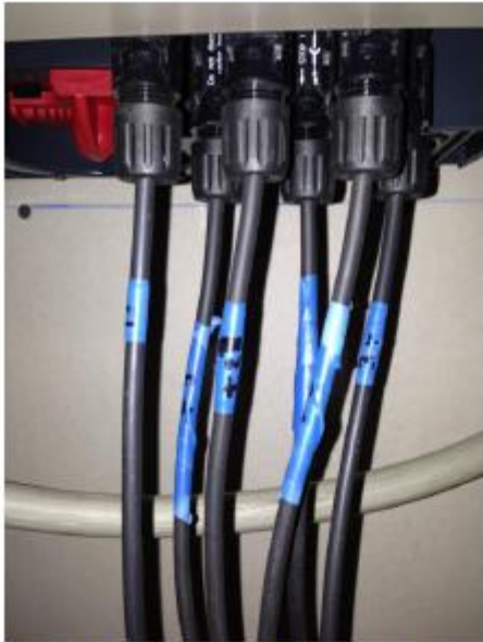
Figur 5 - Mærkningen af kablerne til de enkelte solcellestreng
