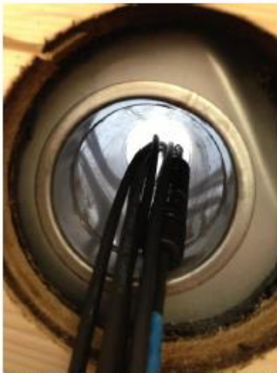
Figur 6 - Kabelgennemføring i taget
