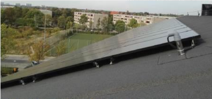
Figur 7 - Solcellepanelernes placering på taget samt kablegennemføring
