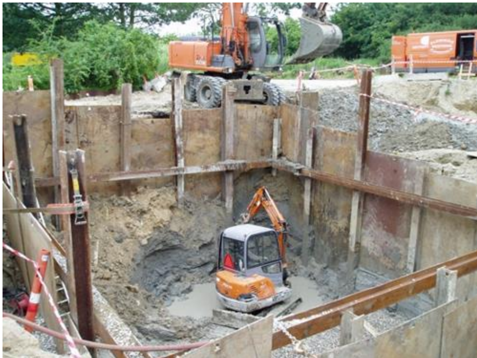
Figur 5: Udgravningen og støbningen af flisgraven foregik under konstant kamp med at holde grundvandspejlet i skak. Det stod ekstra højt på grund af store mængder nedbør i perioden.
