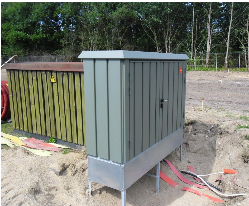
Figur 15: Eltransformeren blev udvidet med et ekstra kabinet til materiellet for tilslutning af gasmotoranlæggets elkabler.
