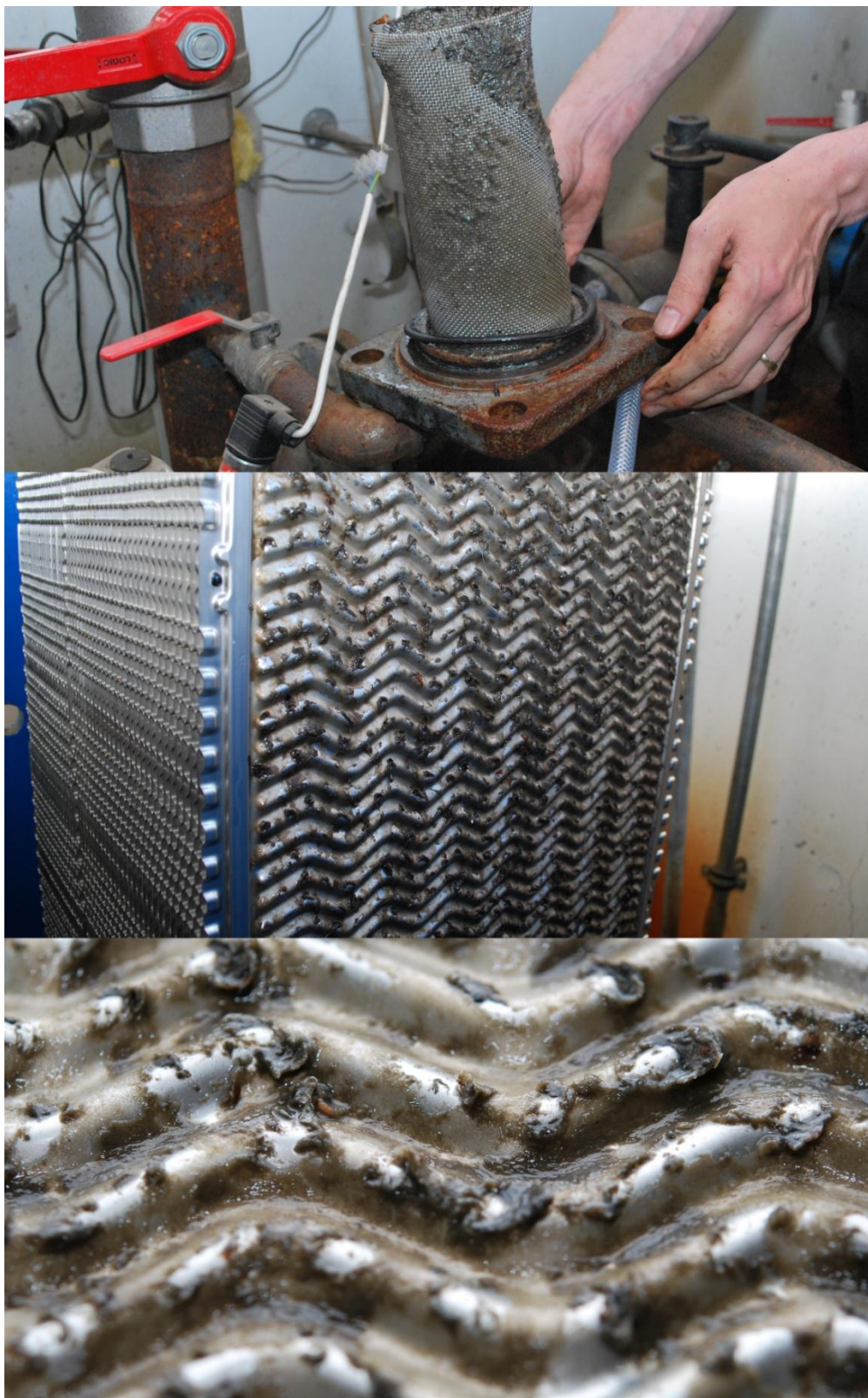
Figur 25. Varmeveksler fra Køle- og Varmepumpeteknik. Øverst: Grovfilter med en del tilbageholdt materiale. Midten: Umiddelbart efter at veksleren er adskilt. Nederst: Nærbillede af belægning på vandsiden af vekslerpladen.
