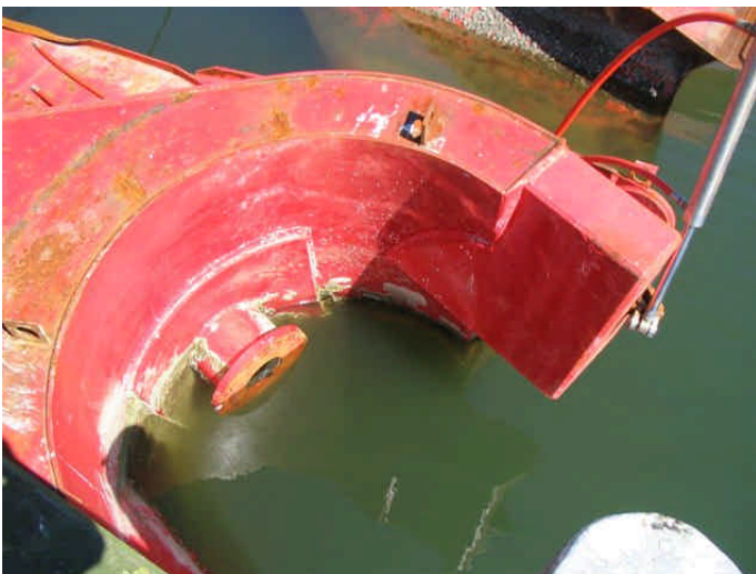
Beslag for cylindre brækket af på platformen. Beslag på vingerne ses at være intakte efter havariet juni 2006.
