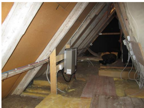
7 - Inverter placeret i loftrum
