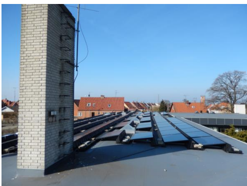
10 - Skorsten kaster skygge på nogle solcellemoduler i morgen og formiddagstimer. Koster lidt elproduktion. (Rønne Bibliotek)
