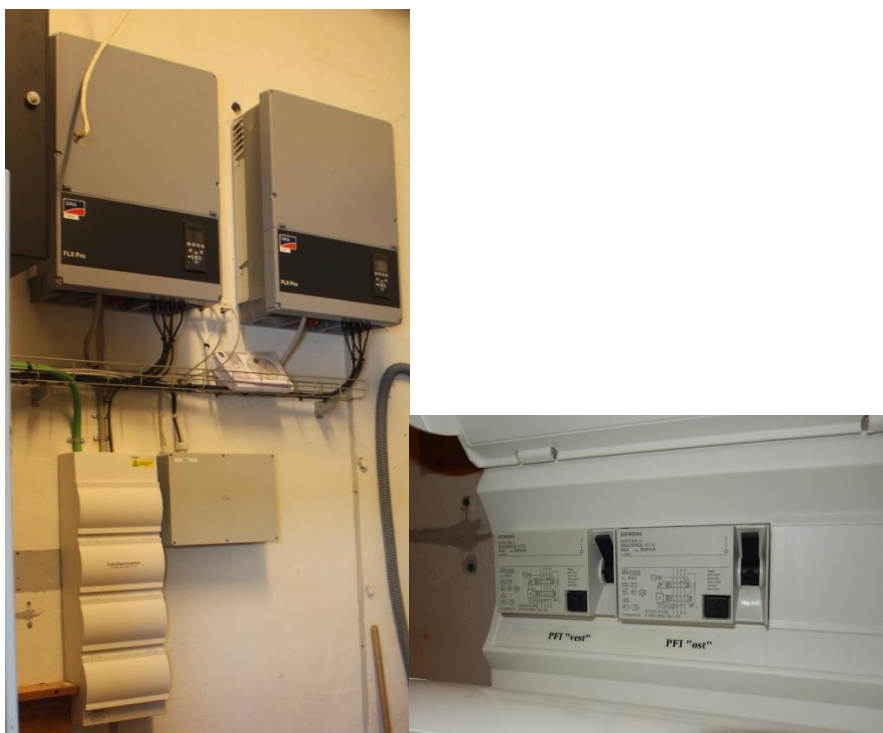
13 - Invertere og de tilhørende PFI-afbrydere i el tavlen. Fejlfri installation. (Nexø Skole)
