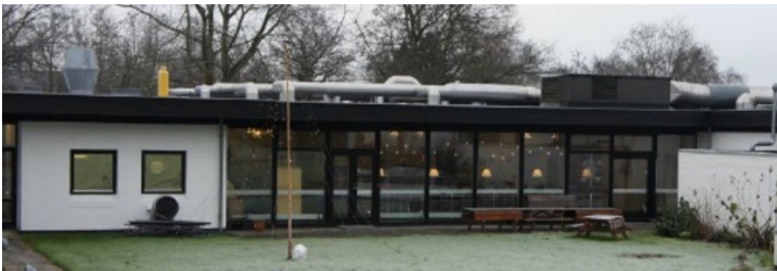
Figur 8 Ventilationskanaler, hvor der er brug for visuel inddækning
