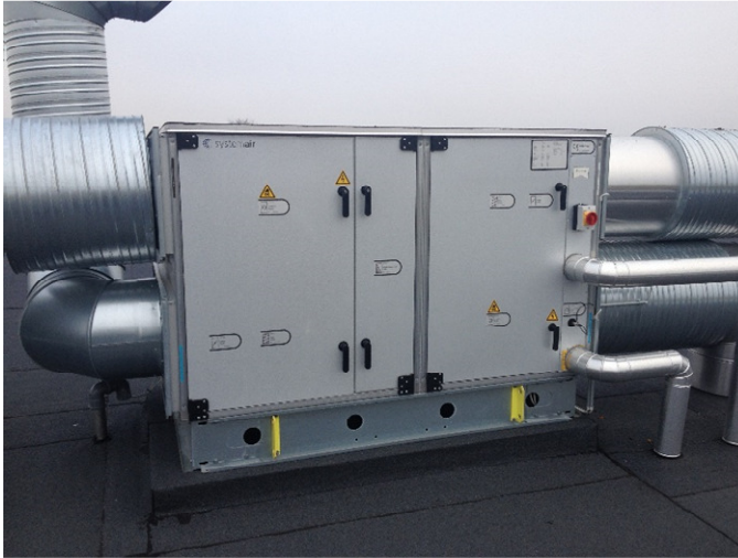
Figur 13 Ventilationsaggregat uden inddækning
