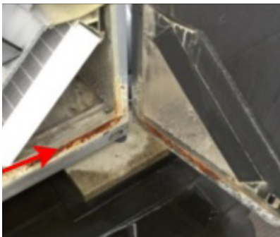
Figur 14 Rustdannelse i karm på ventilationsaggregat
