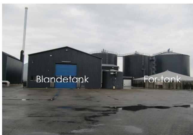
Billede: Blandetank og for-tank ved Thorsø biogas.
