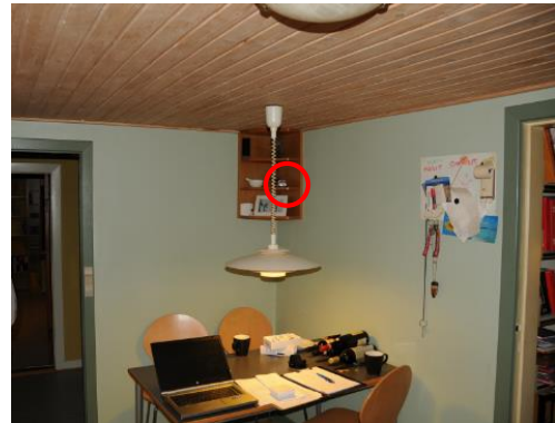
Fig. 10.4: Køkken. Rumføler i hjørneskab (DSC_6638)
