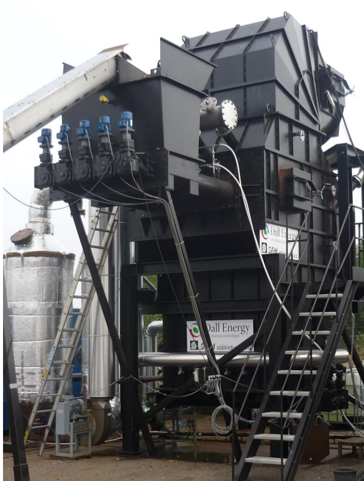
Figur 2.1 Pilot-anlægget hos SEM ståindustri
