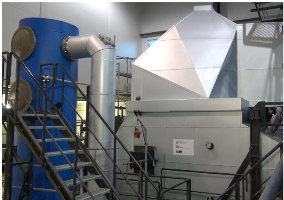
Figur 3.7 Luft befugter og ovn med inddækning april 2011.
