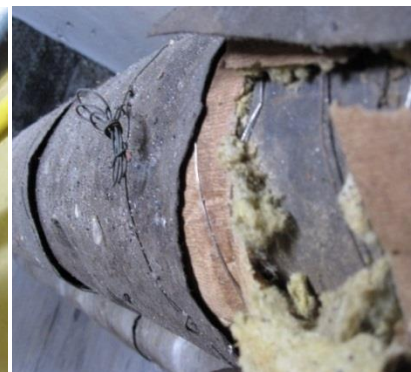
Dårlig isolering af rør på loft.
