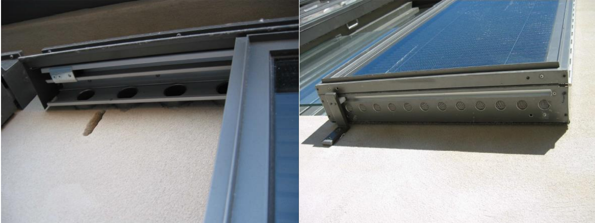
Figur 22 Lufttilførsel til lejligheden (tv) og huller i bund af solskodde (th).
