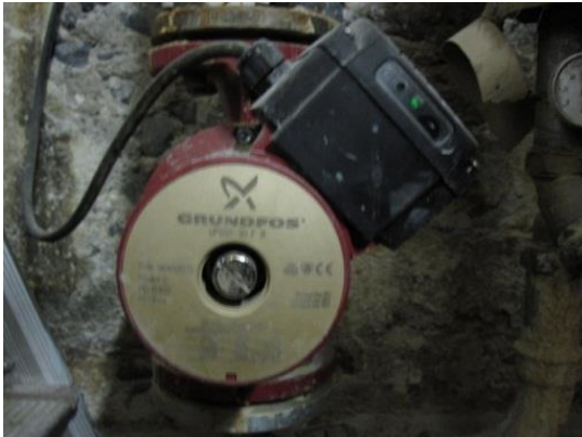
Figur 17 Pumpe til varmt brugsvand.
