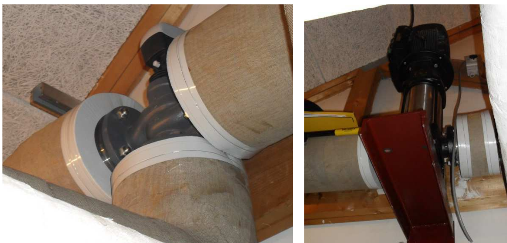
Figur 22: Komponenter i varmecentralen. 3-vejs ventil (til venstre) og booster-pumpe (til højre).
