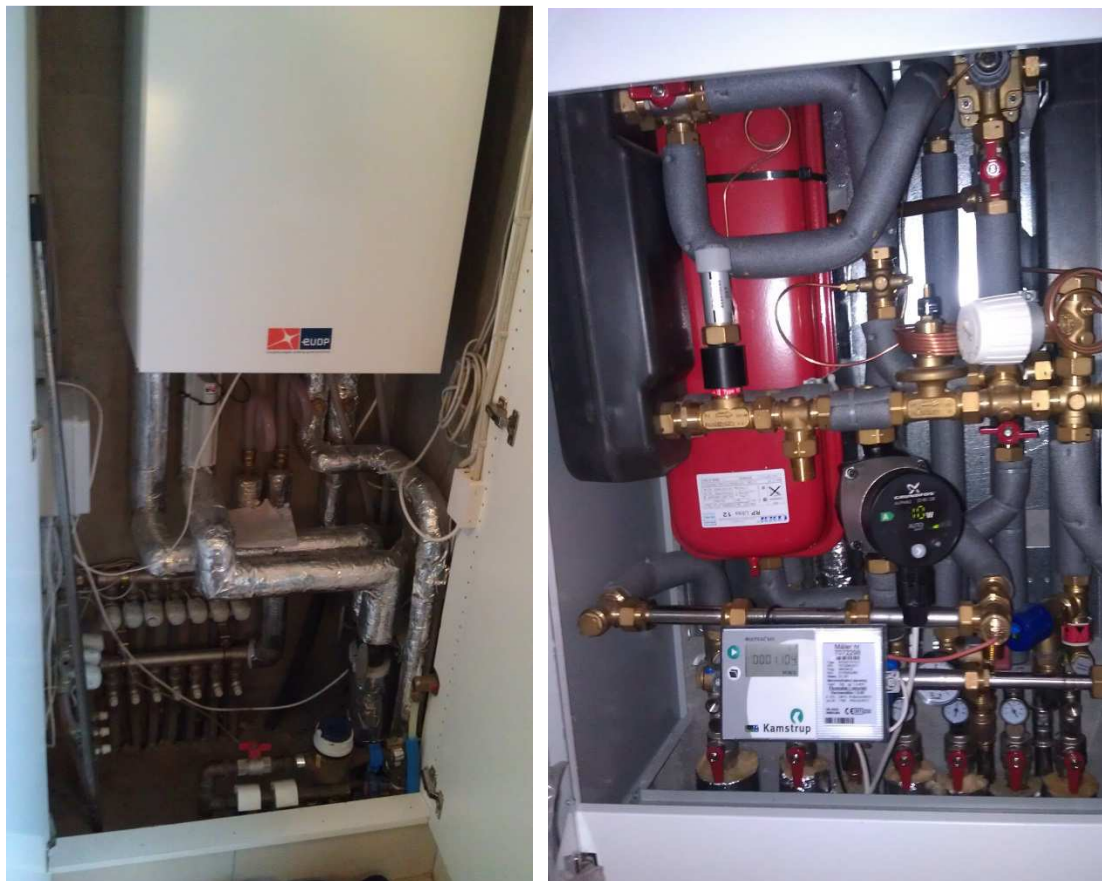
Figur 4: Eksempel på de installerede fjernvarmeunits. (Billede til venstre:) Den samlede brugerinstallation med tilslutninger til fjernvarmestik, vandstik, gulvvarmesystem og forsyningsledninger for brugsvand. EUDP klistermærke er sat på fjernvarmeunittens kabinet. (Billede til højre:) Et kig ind i selve fjernvarmeunitten, hvor den fjernaflæste energimåler også ses.
