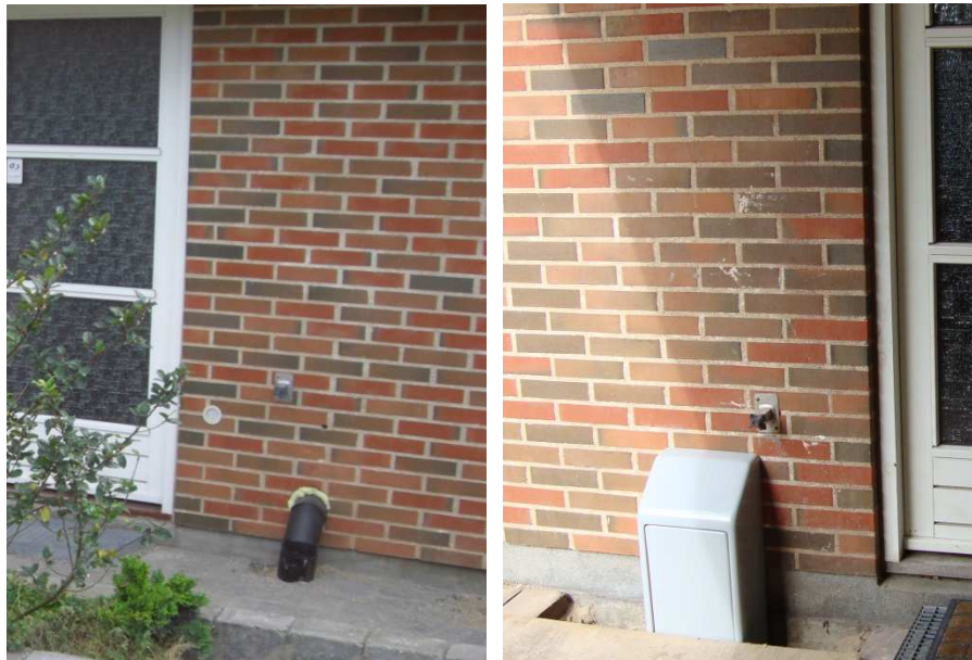
Figur 17: Eksempel på en stikledning, der er ført ind igennem ydervæg i "stikskab".
