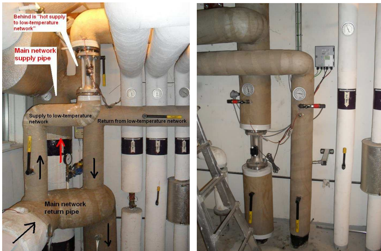
Figur 20: Rørtilslutninger i varmecentralen. Tilslutning til hhv. hovednettet (til venstre) og lavtemperaturnettet (til højre).
