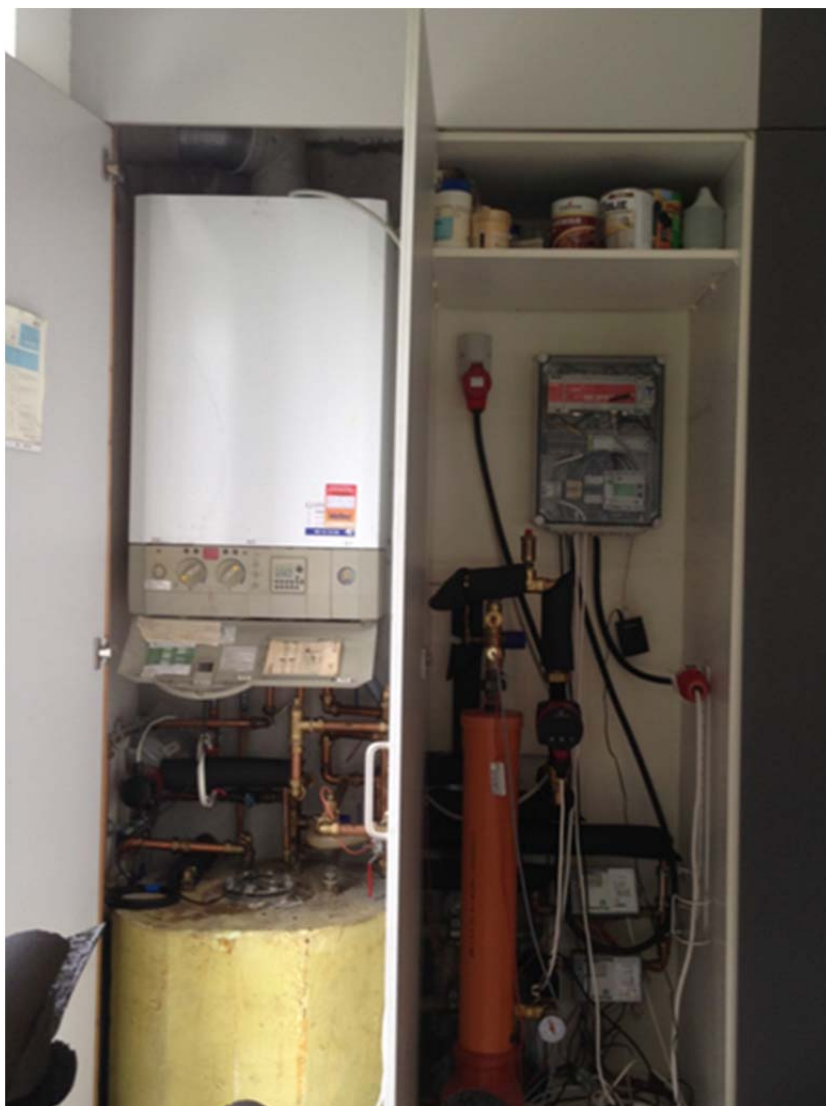
Figur 2 Kokkedal-installation med orange elpatronrør og styreboks (til højre)
