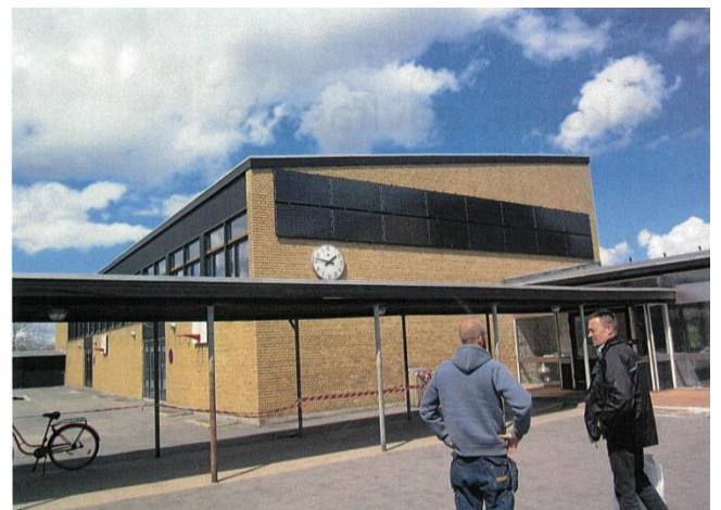
Syvstjerneskolen, Værløse. 3,92 kWp solceller på gavl, 26 m 2
