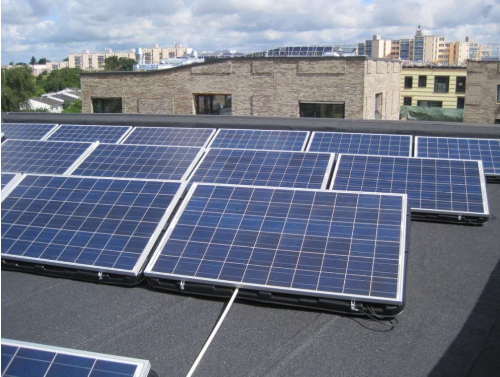
Sønderhaven plejehjem Måløv med 78 kWp solceller.
