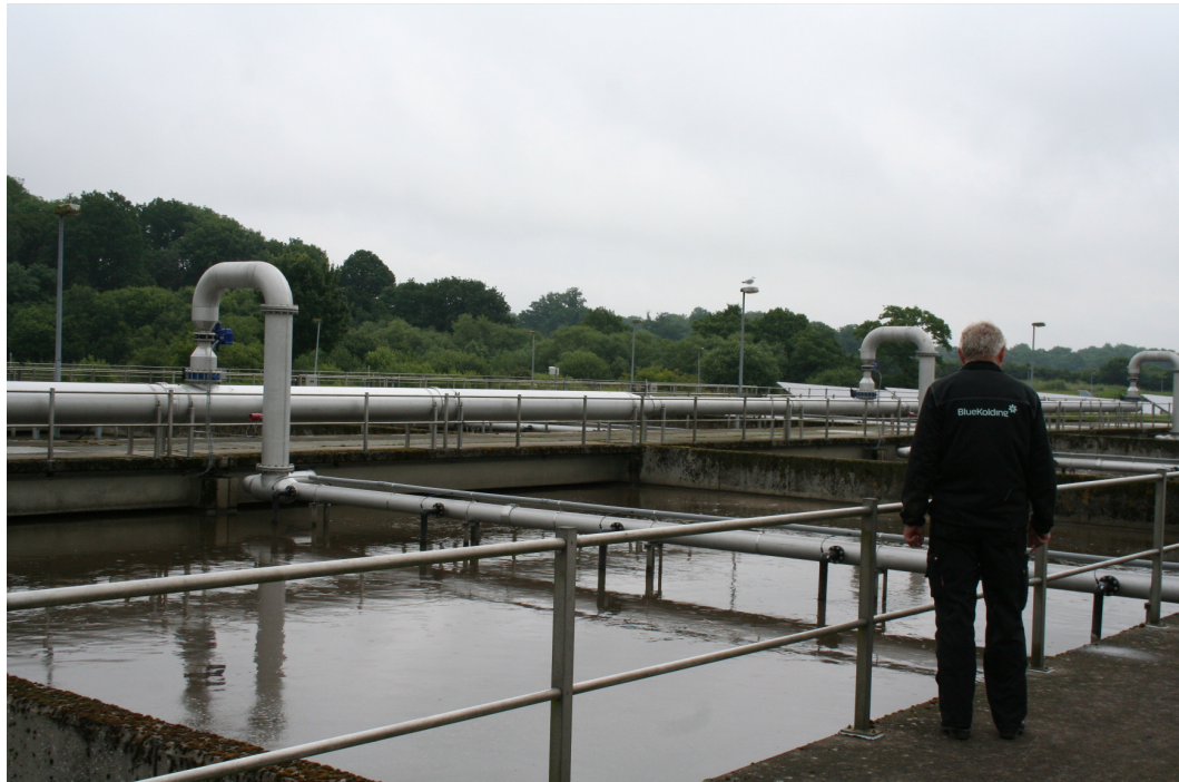
Driftsoperatør overværer beluftningssystemet
