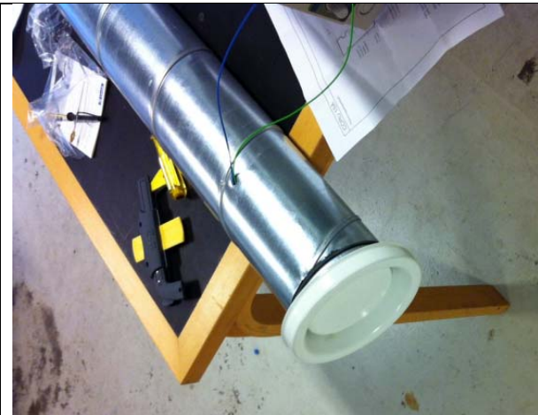
Billede af ventil i opstilling
