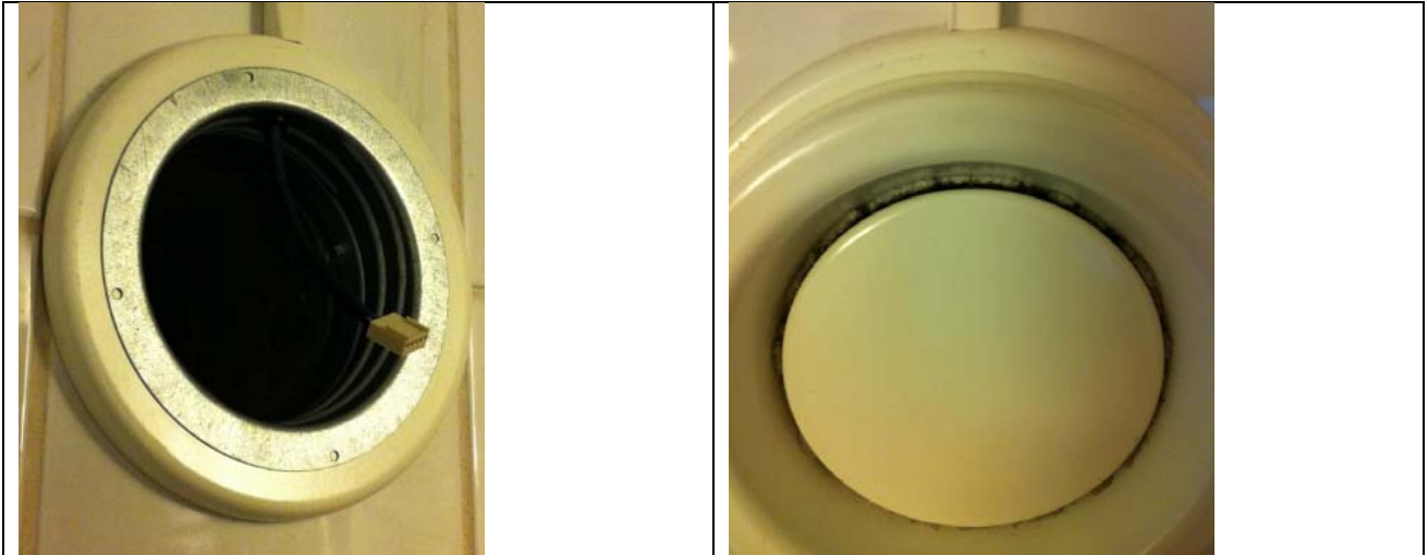
Afsluttet ventilationsarbejde (finish) ses til venstre og montering af ventil til højre.
