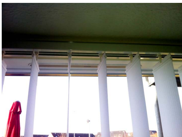
Foto af en lukket friskluftventil i et lejlighedsvindue
