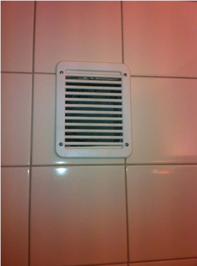
Aftrækskanal på badeværelse.
