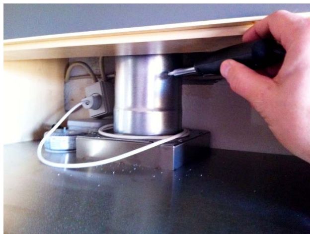
Måling af luftstrøm i kanal (4 steder i røret)
