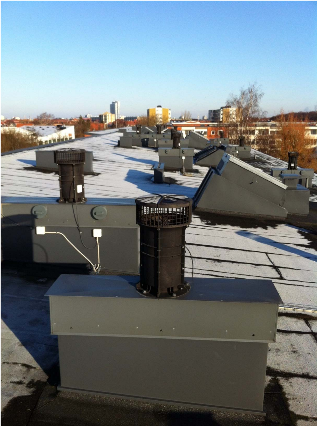
I forgrunden "ses" aftrækskanaler afsluttet i en manifold og hybridventilator.
