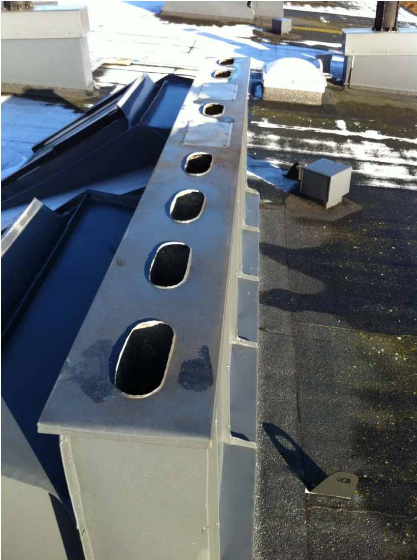
Aftrækskanaler fra kælder.
