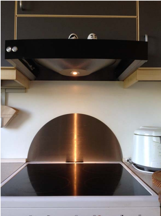
Installeret ny prototype emhætte med lyset tændt. Den anden knap på emhætten kan forcere ventilen til maksimum position.
