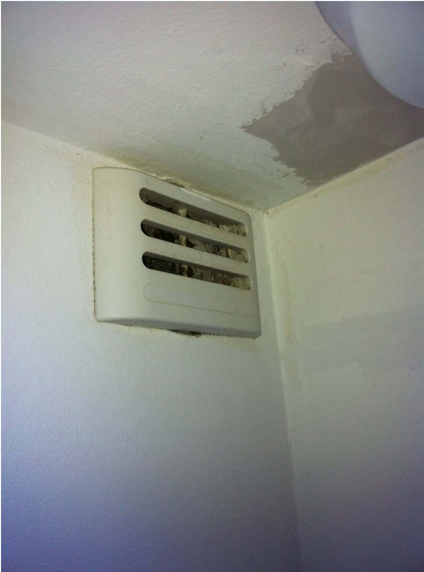
Aftrækskanal i køkken. Ingen emhætte i køkken!
