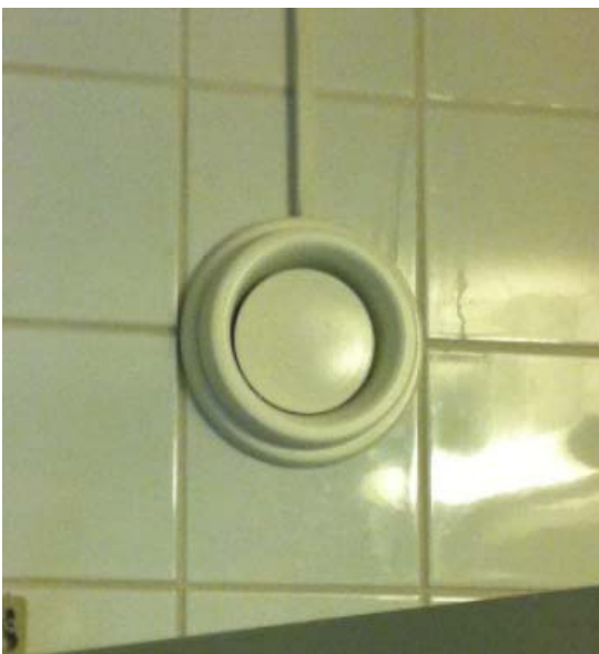
Færdig ventilinstallation. Ventilen kan drejes og hermed skrues ud i tilfælde af kontrol/inspektion/justering.
