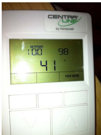
Den nye styring. Setpkt: 100 Pa. Øjebliksværdi: 98 Pa. Aktuel belastningsgrad af ventilatormotor: 41 %
