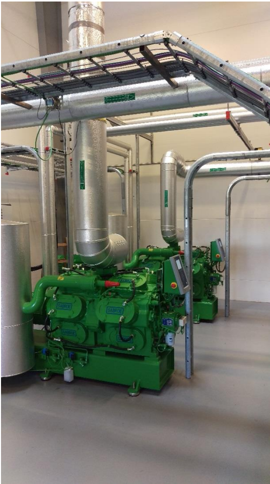
Figur 7 De to kompressorer med lavtryksskuffen forrest.
