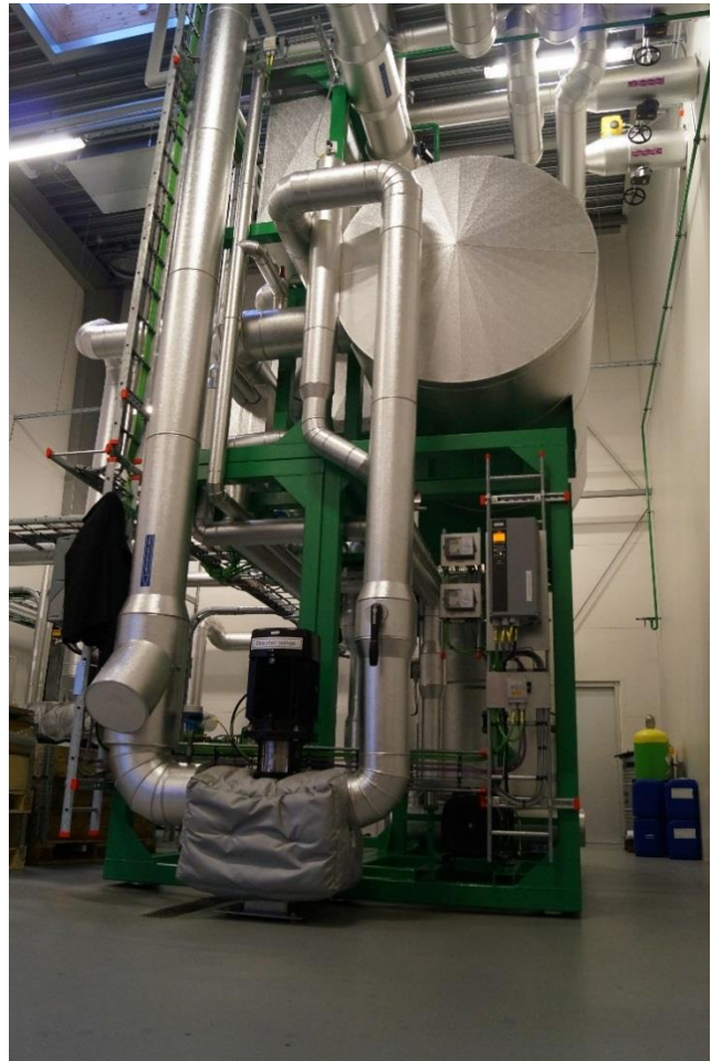
Figur 7 Rammevarmevekslere og væskeseparator. Pumpe for "kølet vand" (desorber) ses forrest.
