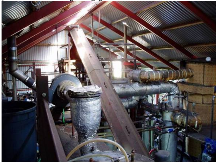
Figur 1: Castoranlæggets maskinhal set i første etages højde.
