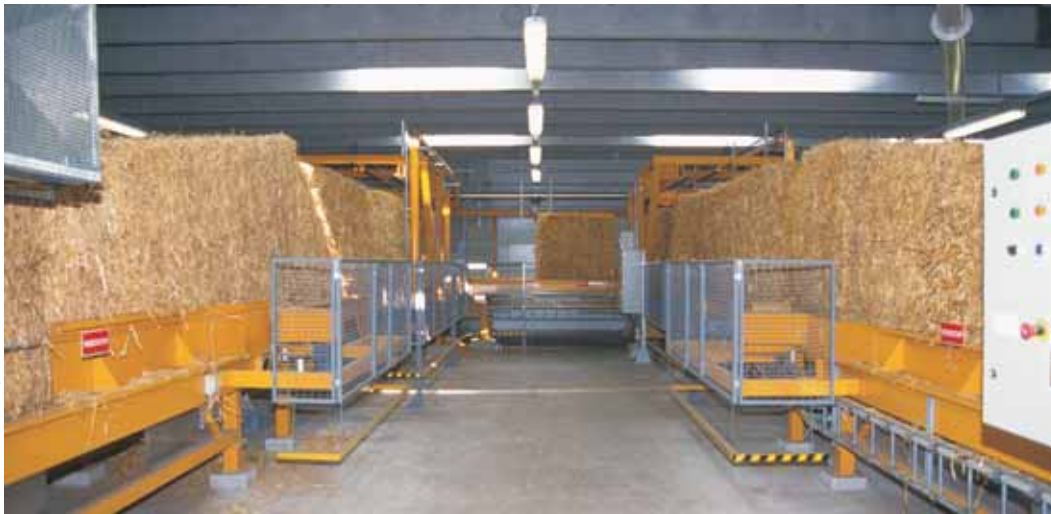
To af de fire halmlinier på Studstrupværket, der fører halmen fra lageret hen til op-riverne.
